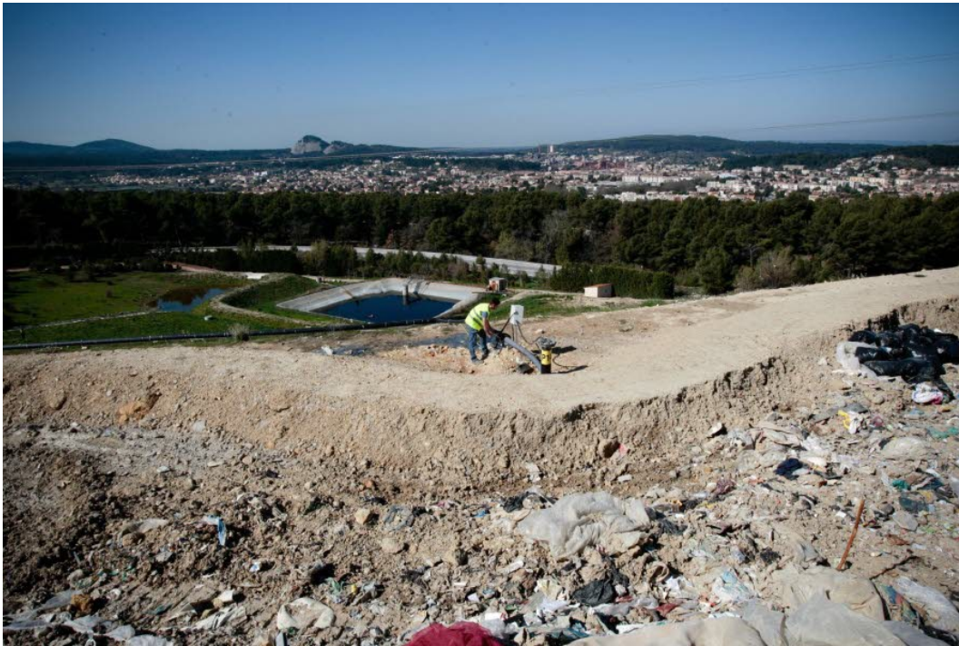
Le chantier de la future usine biomasse de Gardanne a déjà débuté dans les Bouches-du-Rhône.
